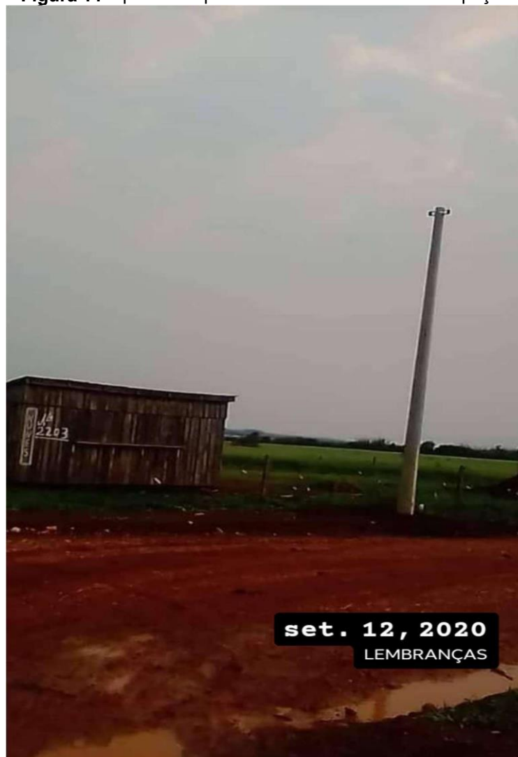
Figura 11 – primeiros postes de luz instalados na ocupação
