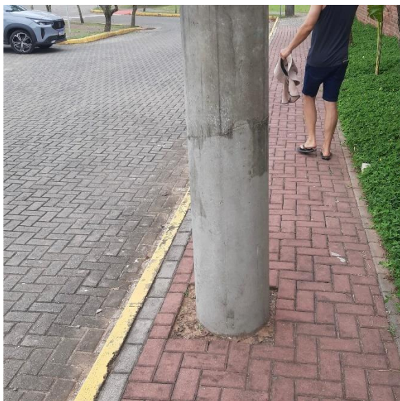
Foto 37 – Observa-se um poste obstruindo a locomoção dos pedestres.
