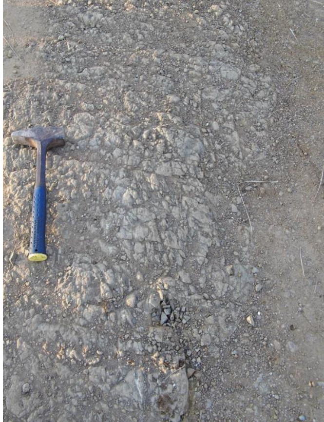
Figura 30 – Arenito intensamente fraturado e intemperizado, próximo do comprimento de 355 m de linha.
