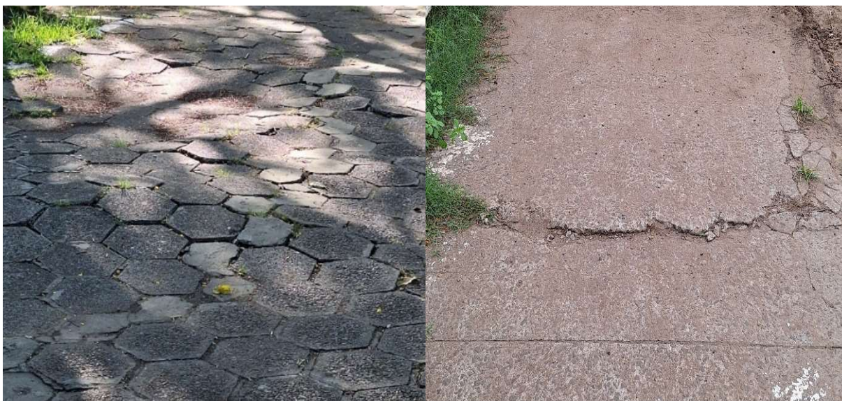
Figura 76 – Irregularidade da superfície da calçada – Avenida Alexandre Lisboa
