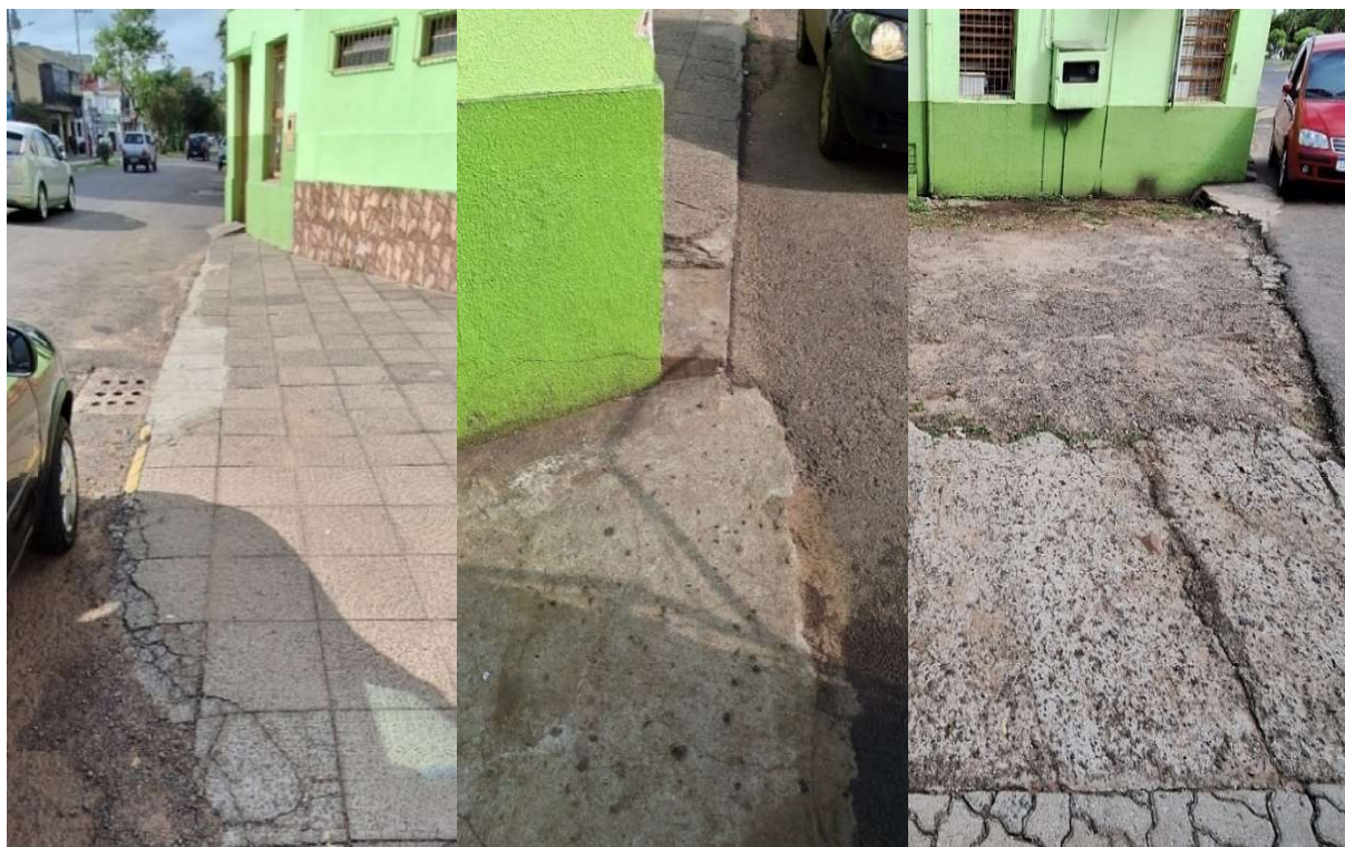
Figura 72 – Segunda irregularidade grave – Avenida Tiarajú
