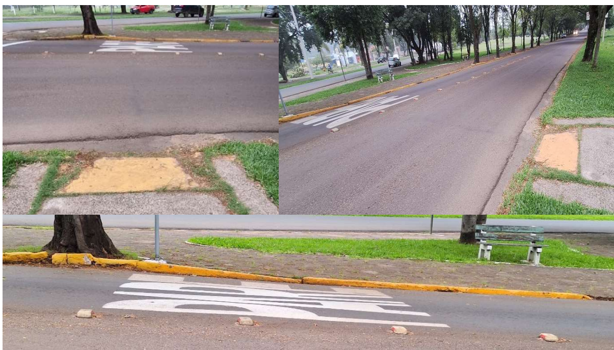
Figura 66 – Ausência de rampa de travessia na Avenida Alexandre Lisboa
