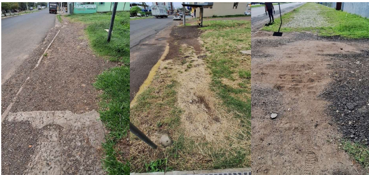
Figura 81 – Descontinuidade de calçadas por interrupção abrupta da pavimentação
