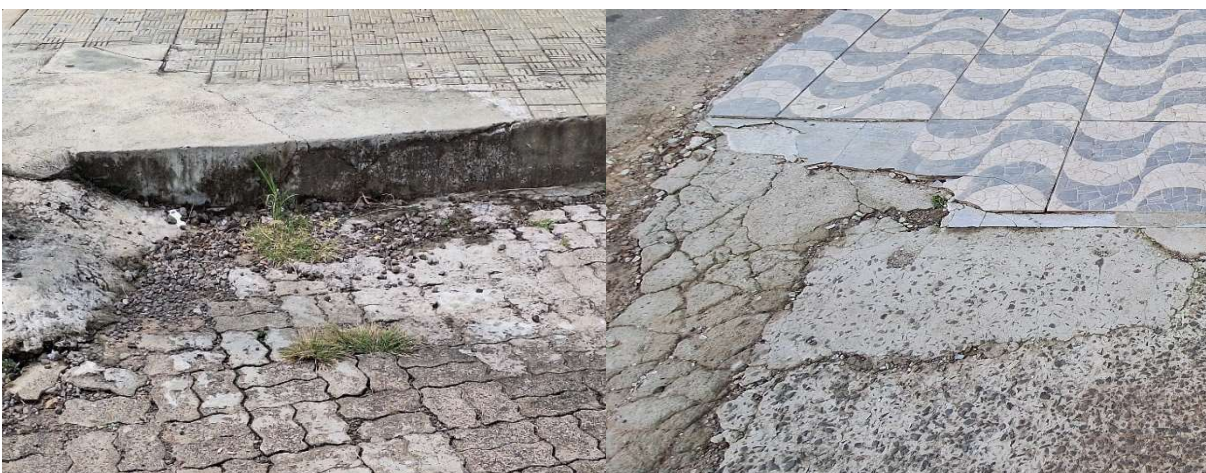
Figura 79 – Irregularidade da superfície da calçada – Avenida Tiarajú
