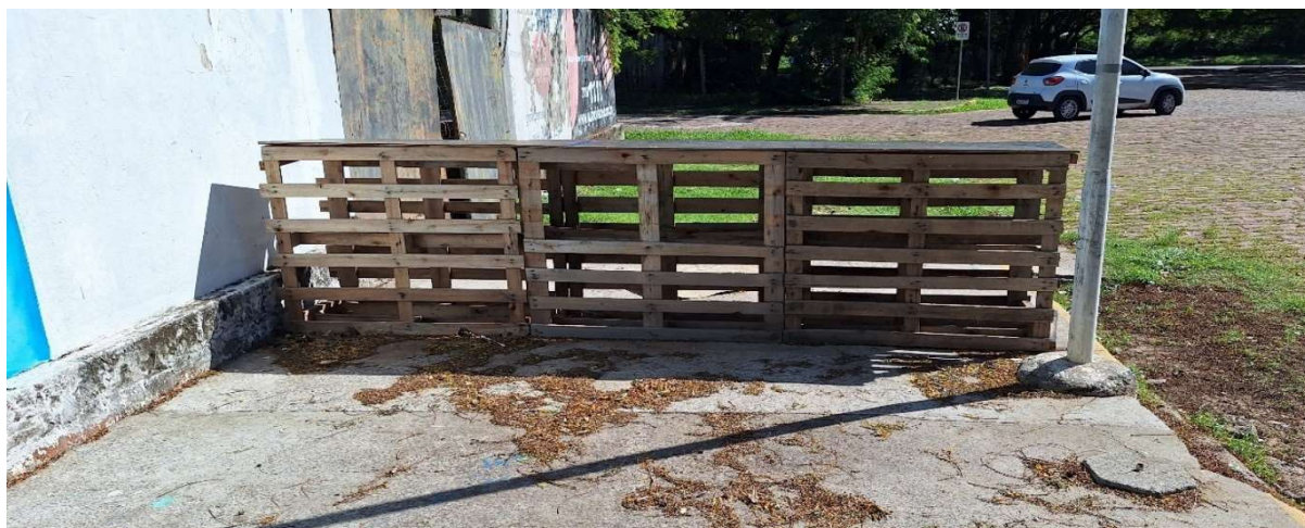
Figura 85 – Obstrução de passeio público
