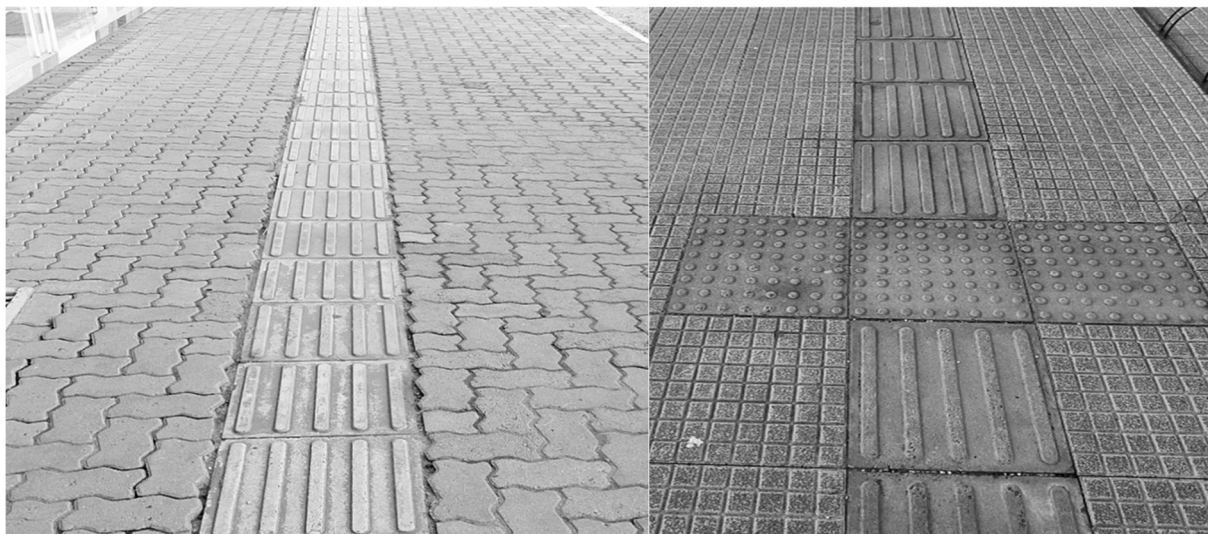
Figura 89 – Sinalização podotátil sem contraste de luminância
