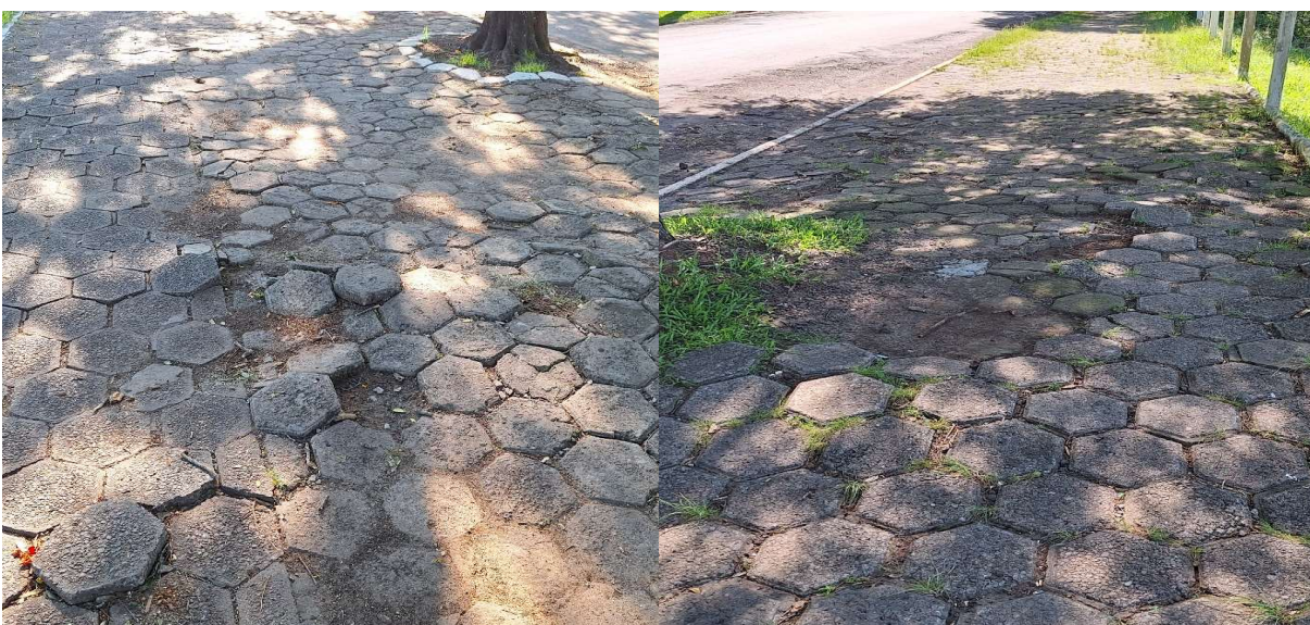
Figura 77 – Irregularidade da superfície da calçada – Avenida Eurípedes Brasil Milano
