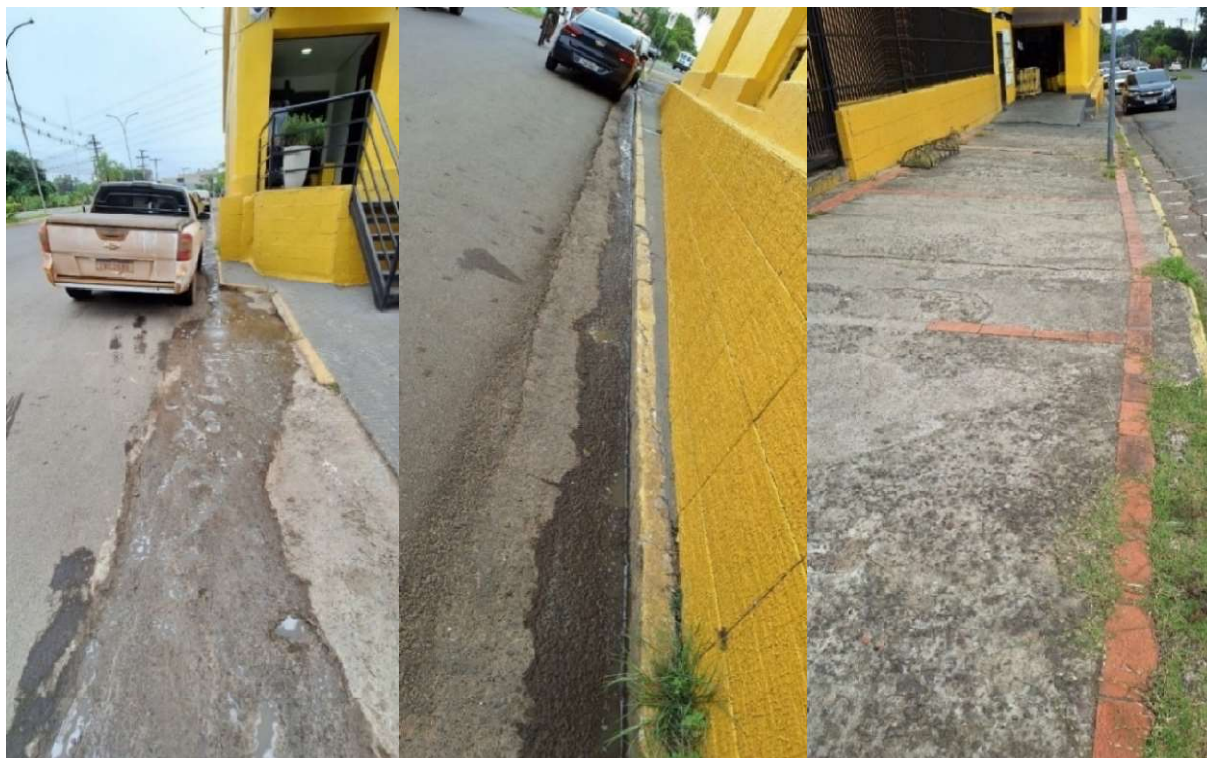
Figura 71 – Primeira irregularidade grave – Avenida Ibicuí
