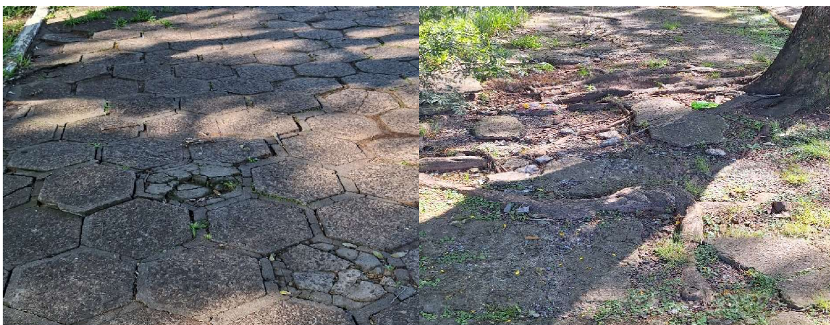
Figura 80 – Irregularidade da superfície da calçada – Rua Plínio Brasil Milano
