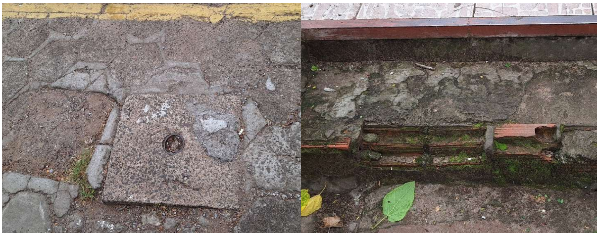
Figura 78 – Irregularidade da superfície da calçada – Avenida Ibicuí
