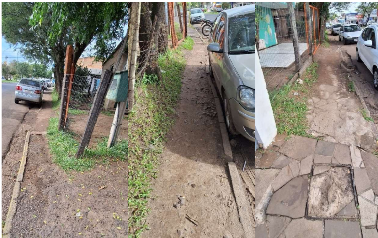
Figura 73 – Terceira irregularidade grave – Avenida Tiarajú
