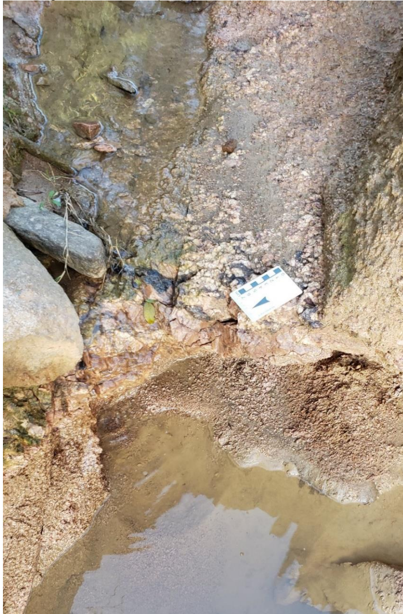
Figura 30 - Erosão tipo “pipe” sobre soleira de pegmatito.
