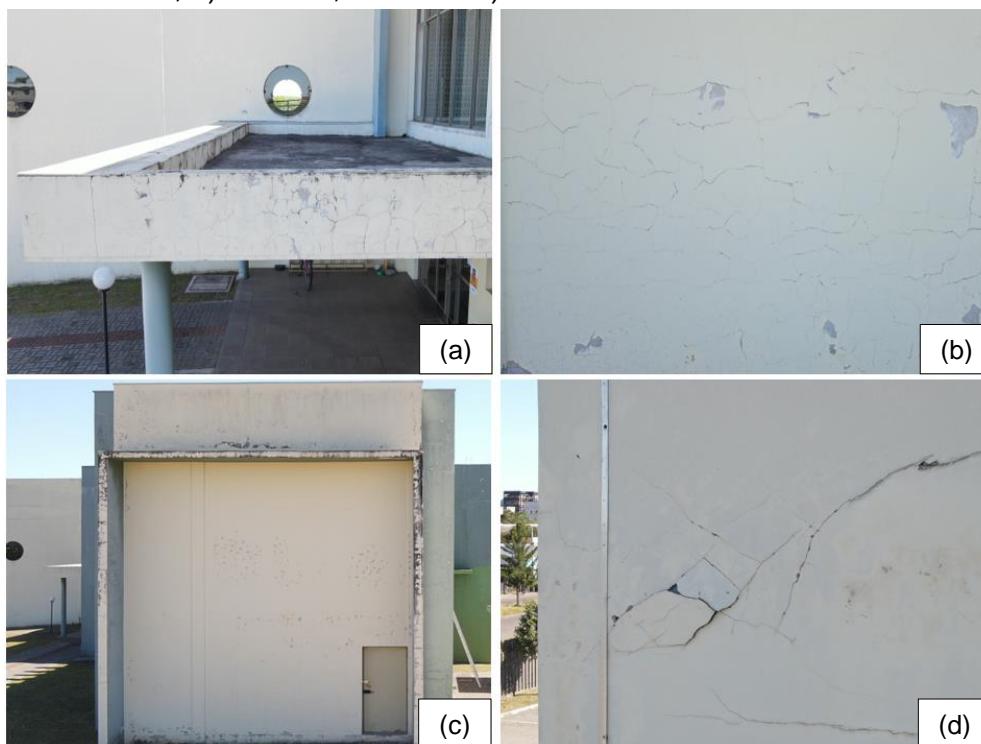
Figura 45 – Manifestações patológicas da fachada sul, onde: a) fissuras mapeadas; b) descascamentos; c) bolores, mofo e d) descolamentos
