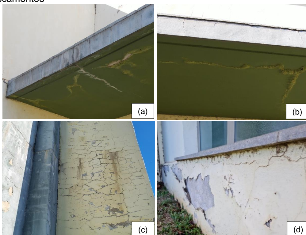
Figura 58 – Manifestações patológicas da fachada norte, onde: a) fissuras horizontais e eflorescências; b) vesículas; c) fissuras mapeadas com eflorescências e d) descascamentos
