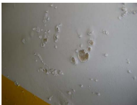
Figura 16 – Destacamento de pintura oriunda de vesículas em revestimento argamassado
