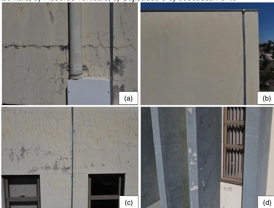
Figura 52 – Manifestações patológicas da fachada leste, onde: a) Fissuras mapeadas e horizontais; b) Fissuras verticais; c) Sujidades e d) descascamento
