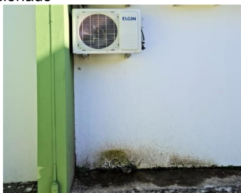
Figura 64 – Anomalia de bolor e mofo na fachada leste em decorrência de ausência de dreno para o ar condicionado
