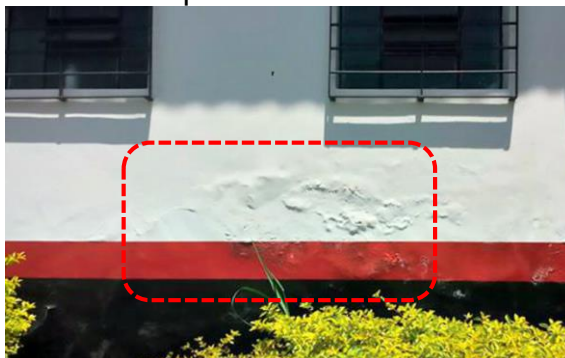
Figura 10 – Descolamento com empolamento
