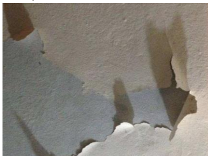
Figura 15 – Descascamento de pintura
