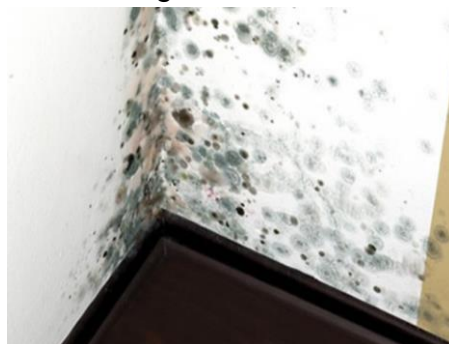
Figura 14 – Bolor em revestimento argamassado
