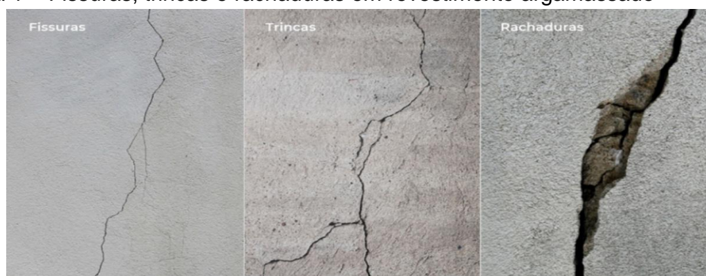
Figura 1 – Fissuras, trincas e rachaduras em revestimento argamassado
