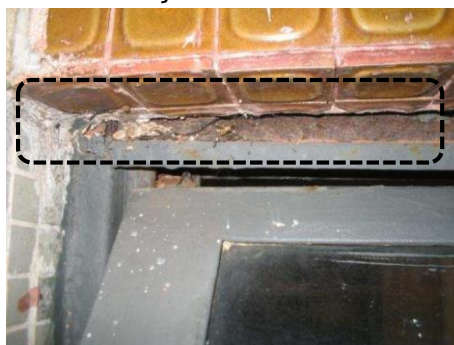
Figura 18 – Detalhe de falha de vedação
