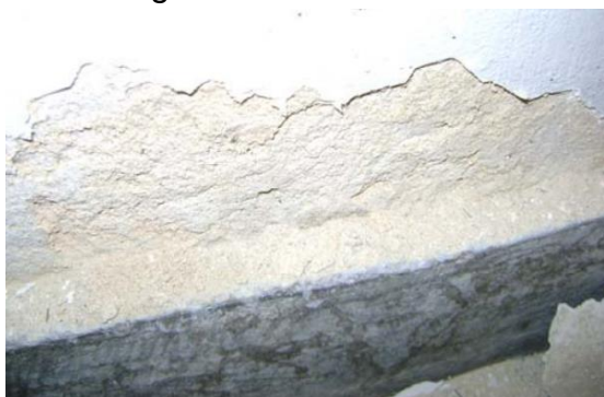
Figura 12 – Descolamento da argamassa
