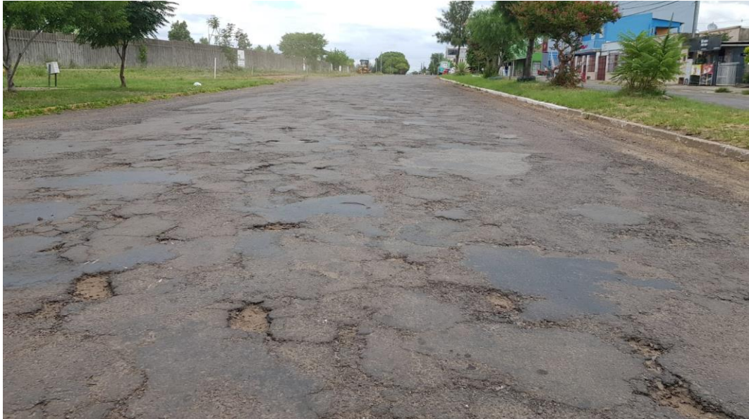
Figura 19 – Estado de conservação Av. Caverá – Trecho com “tapa buracos”.
