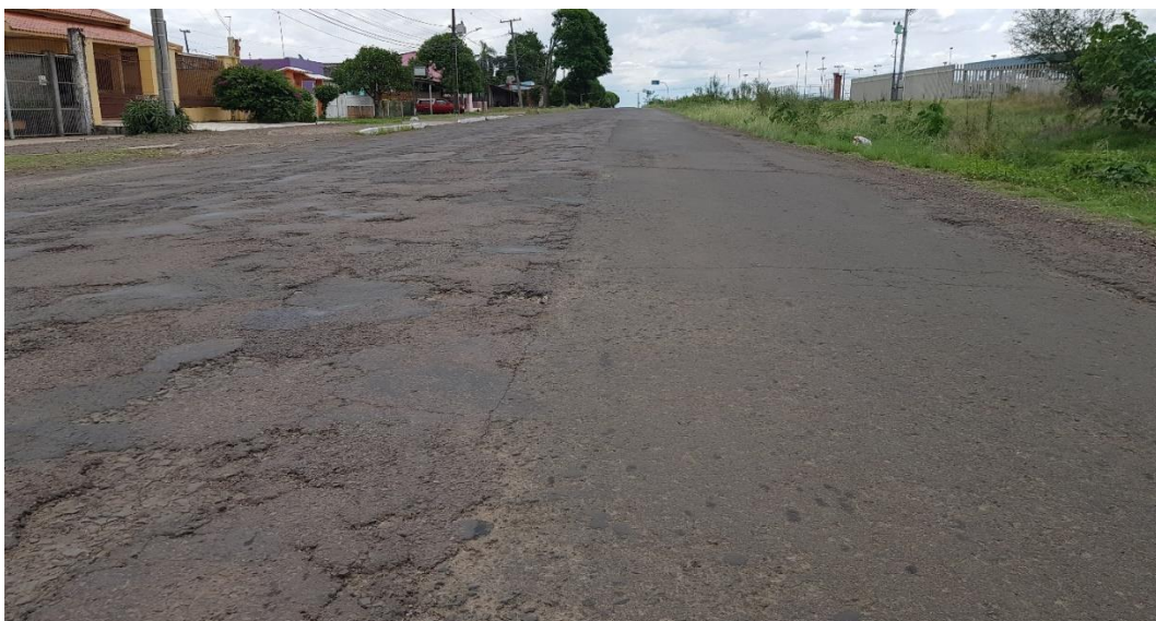
Figura 18 – Estado de conservação Av. Caverá – Trecho com remendos.
