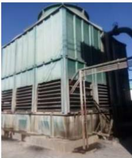
Figura 15 - Torre de resfriamento
