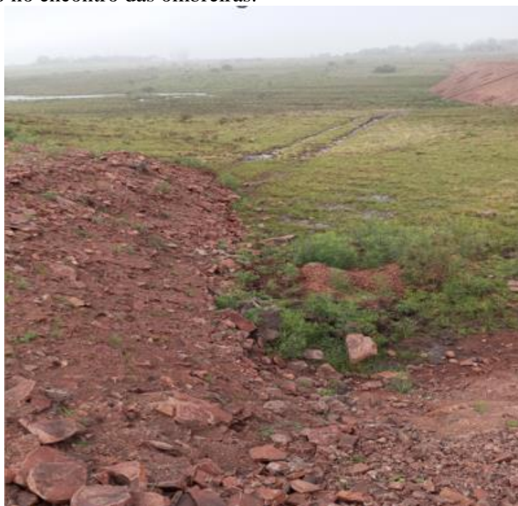
Figura 64 - Erosão no encontro das ombreiras.
