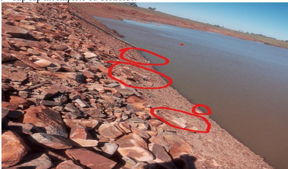
Figura 59 - Rip-rap incompleto ou destruído.
