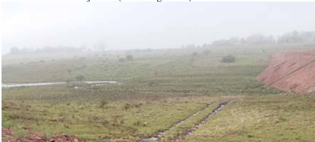
Figura 67 - Erosão na área a jusante (erosão regressiva).
