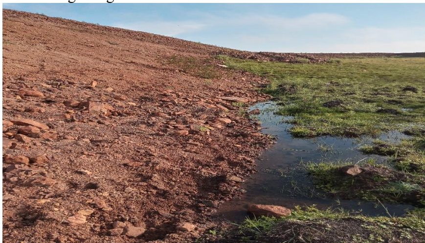
Figura 65 - Sinais de fuga d'água ou áreas úmidas.
