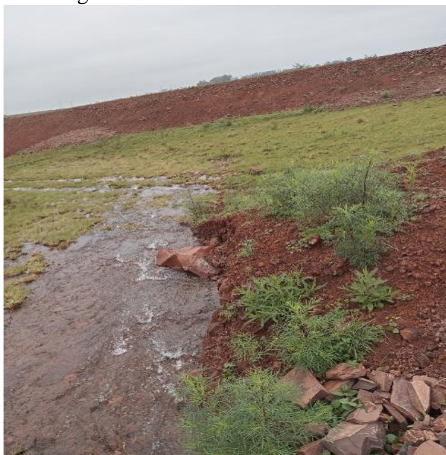
Figura 66 - Erosões ou escorregamento nos taludes.
