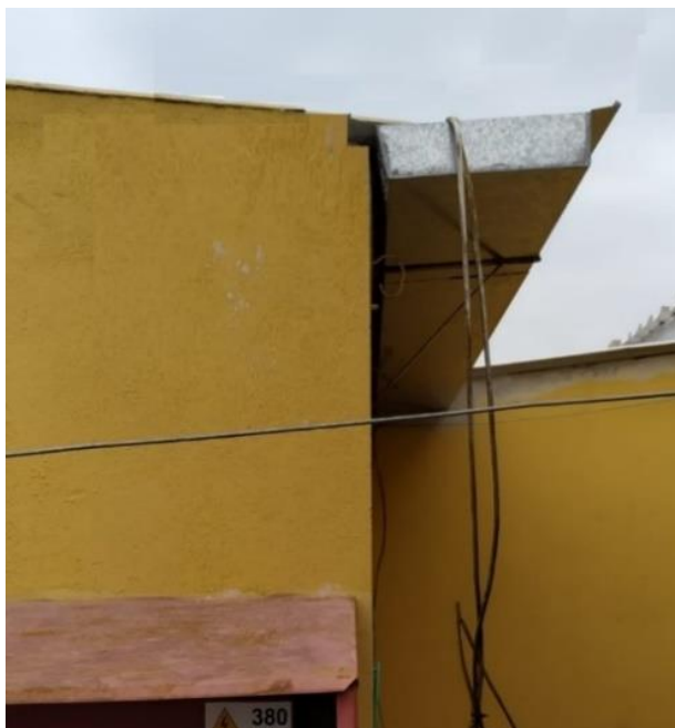
Figura 13 – Calha coletora no telhado 1 (T 1 )
