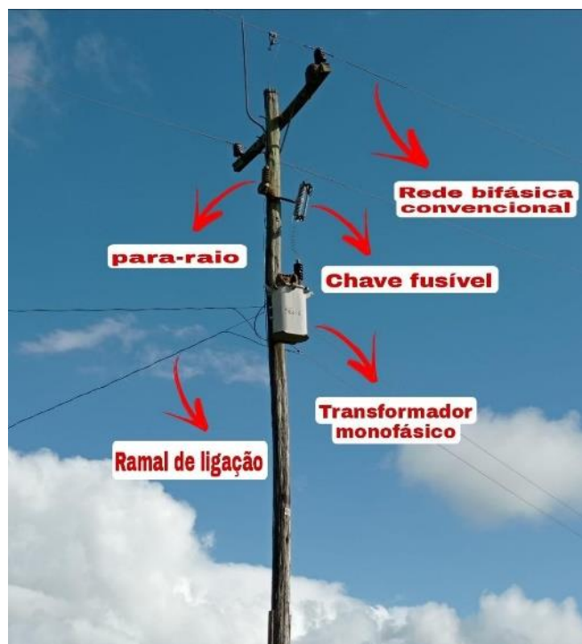
Figura 3 – Alguns elementos da rede de distribuição
