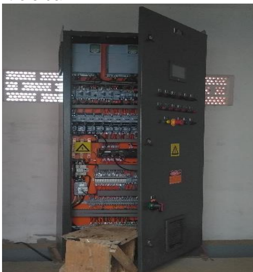
Figura 19 – Painel de controle da ETA
