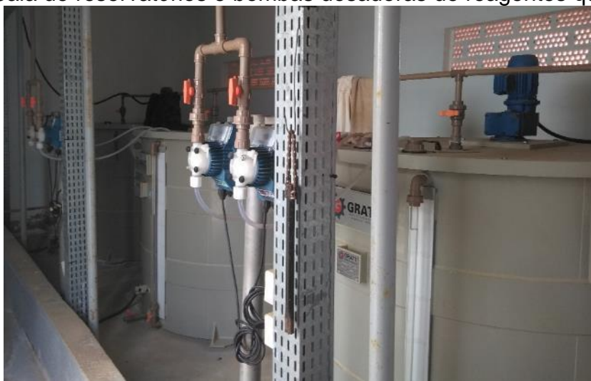
Figura 14 – Sala de reservatórios e bombas dosadoras de reagentes químicos
