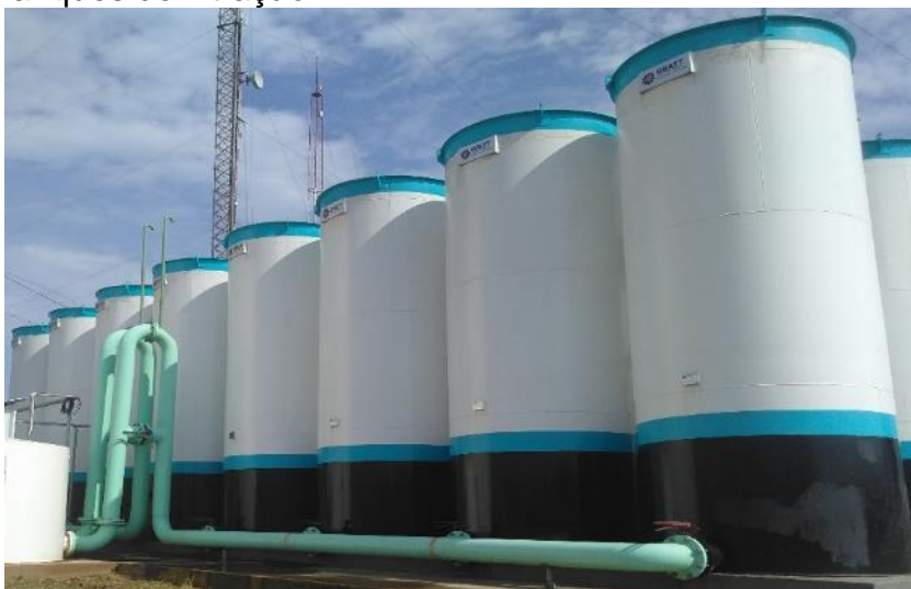
Figura 15 – Tanques de filtração
