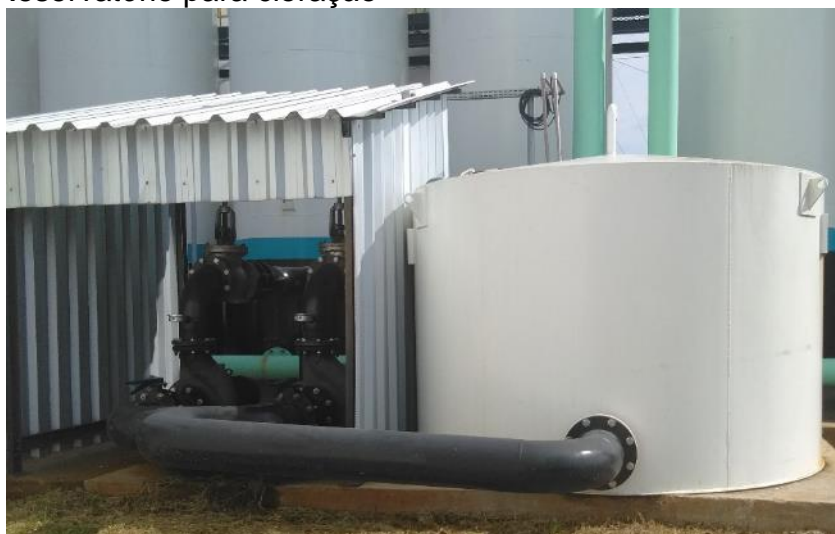
Figura 16 – Reservatório para cloração
