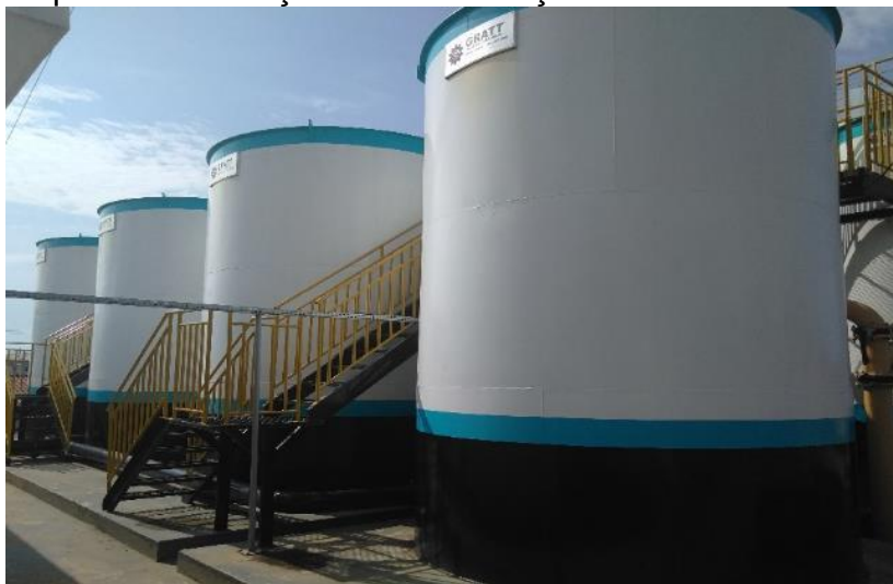
Figura 12 – Tanques de floculação e sedimentação
