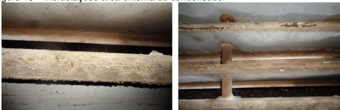
Figura 16 – Incrustações área externa do condensador
