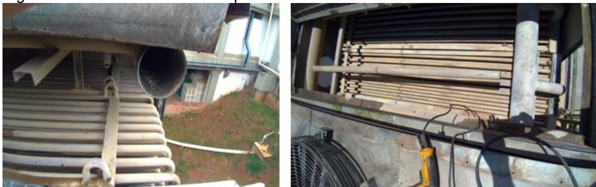
Figura 13 – Estado atual das serpentinas
