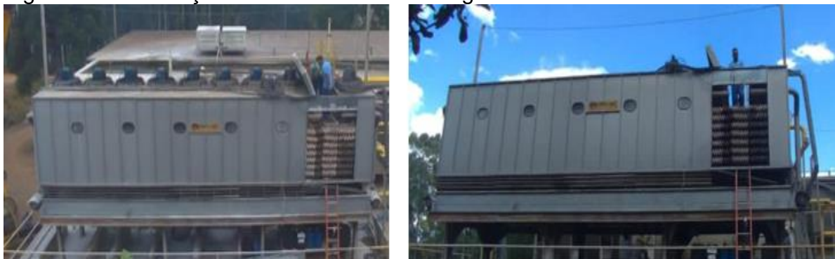
Figura 12 – Instalações do condensador do frigorífico
