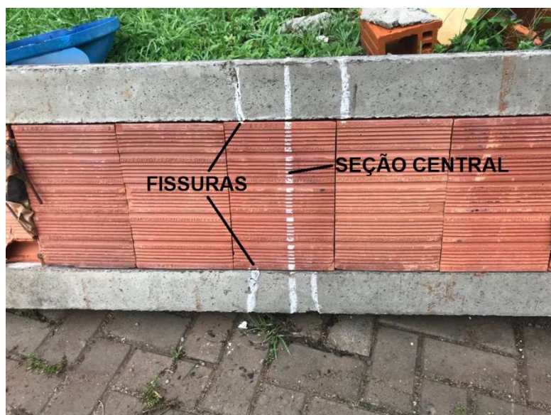
Figura 39 – Fissuras destacadas em exemplar de laje com vigotas protendidas
