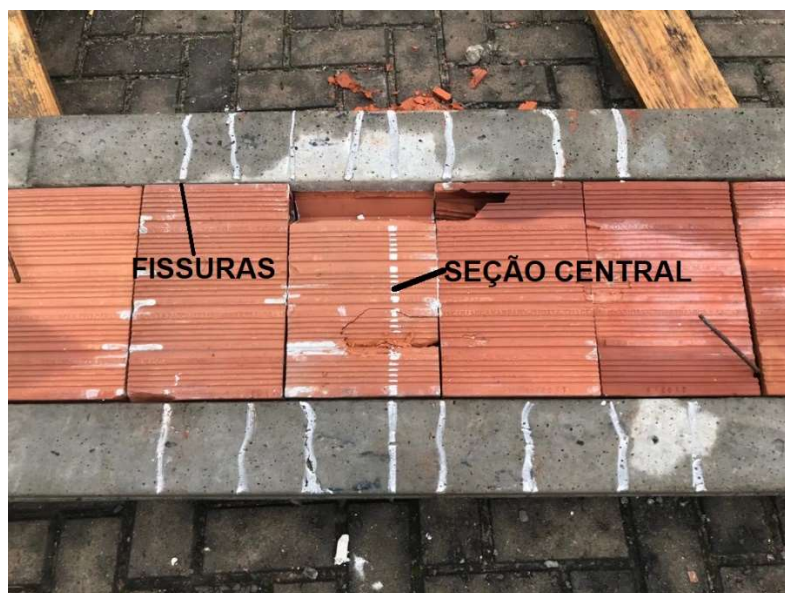
Figura 40 – Fissuras destacadas em exemplar de laje com vigotas treliçadas
