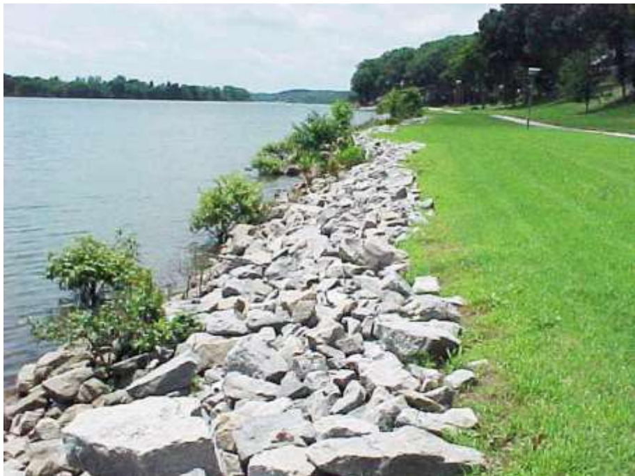
Figura 4: Revestimento por enrocamento no Rio Potengi em Natal, Brasil. FONTE: Google Imagens.
