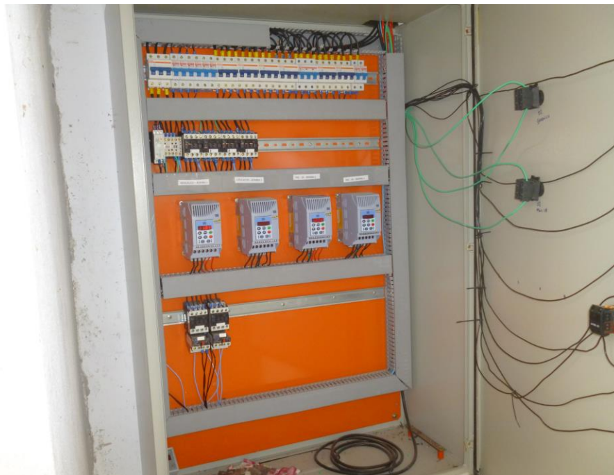
Figura 18: Quadro de automação
