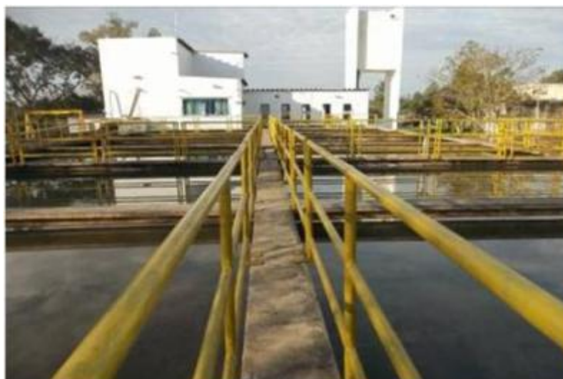
Figura 7: Vista geral da planta de tratamento de água da São Gabriel Saneamento Fonte: SGS, 2014.
