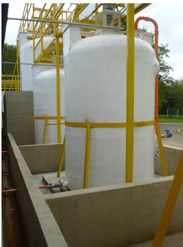
Figura 14: Tanques de armazenamento
