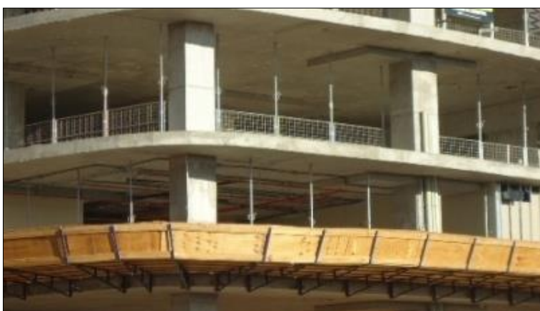
Figura 9 – Sistema de Proteção coletiva
