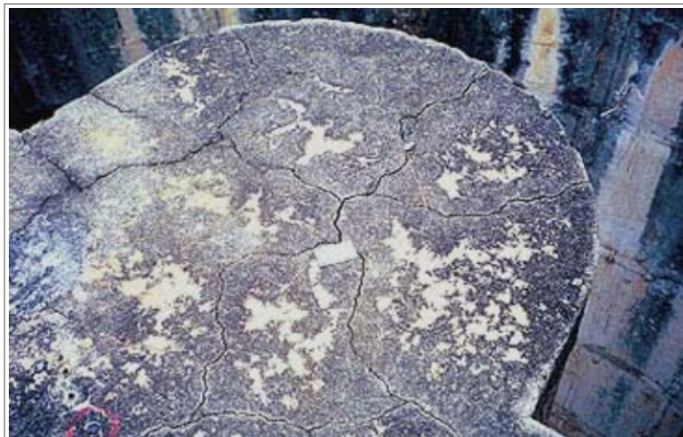
Figura 2 – Topo de pilar de vertedouro de barragem acometida pelo RAA
