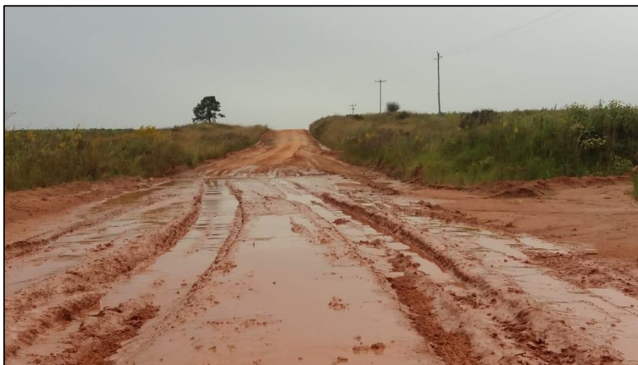
Figura 8 - Buracos Cobertos de Água
