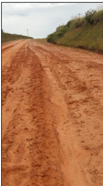
Figura 3 - Seção Transversal Imprópria
