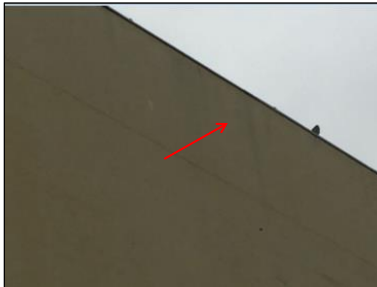
Figura 51 – Manchas na Platibanda do Prédio Administrativo – Fachada Norte
