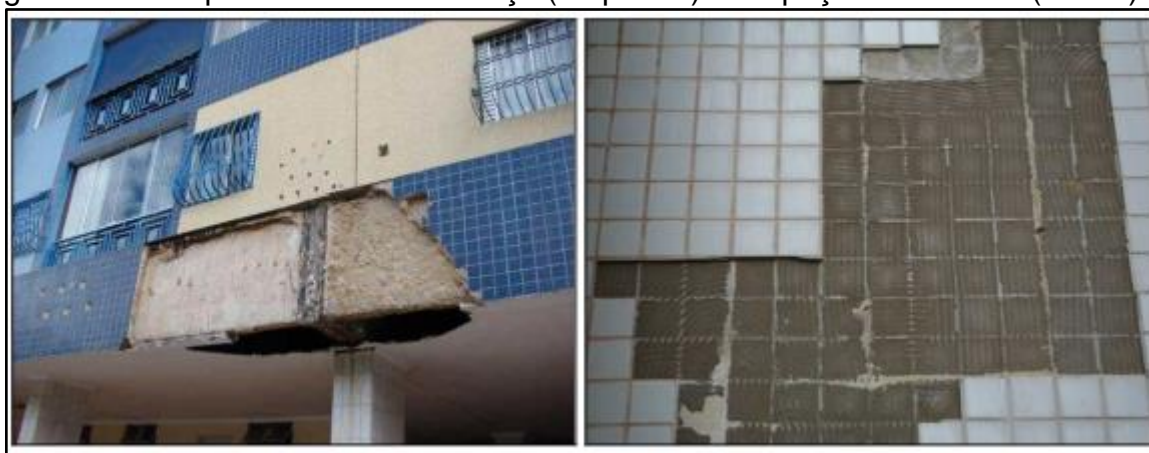
Figura 16 – Deslocamento do emboço (esquerda) e de peças cerâmicas (direita)
