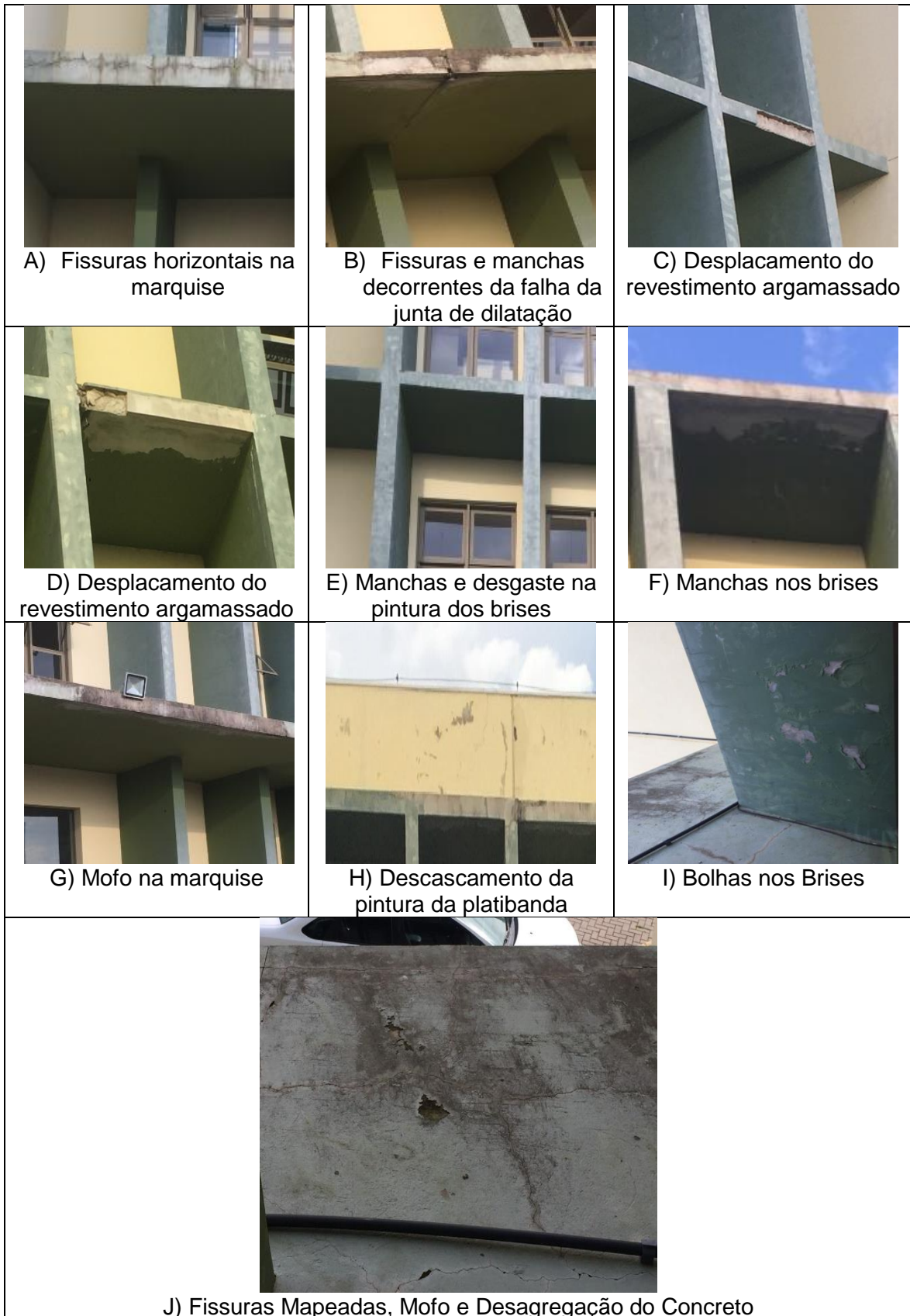
Figura 61– Ficha de Identificação das Patologias no Prédio Administrativo – Prumada 3
