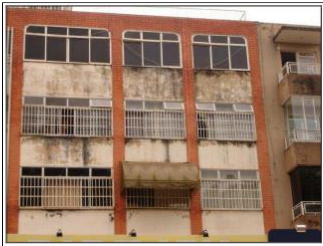
Figura 25 – Manchas de bolor ou mofo
