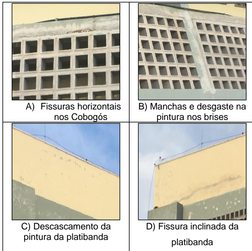
Figura 64 – Ficha de Identificação das Patologias no Prédio Administrativo – Fachada Oeste
