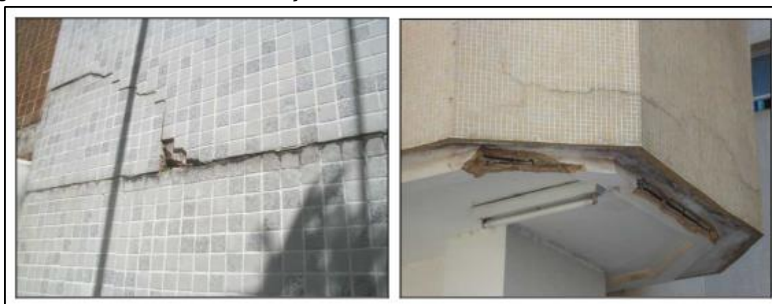
Figura 19 – Detalhes de Fissuração
