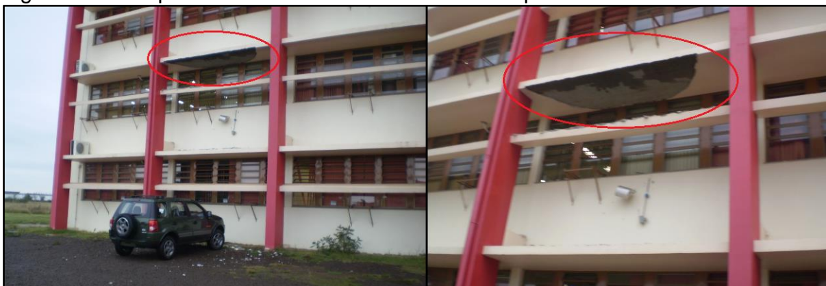
Figura 30 – Deslocamento do Revestimento da Marquise
