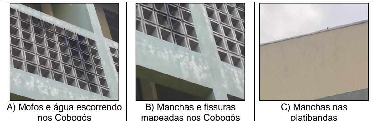
Figura 70 – Ficha de Identificação das Patologias no Prédio Administrativo – Fachada Leste
