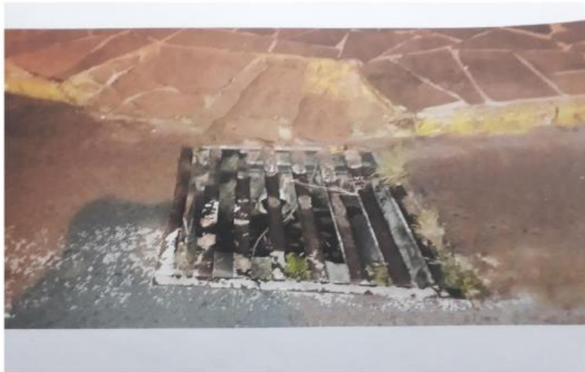
Imagem 7: descaso com a acessibilidade
