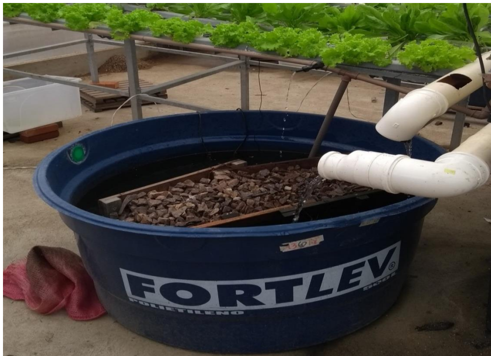
Figura 2 - Reservatório de água com filtro biológico para nitrificação da amônia
