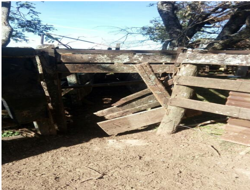
Figura 4 - Mangueiras com estrutura quebradas, dificultando o manejo.
