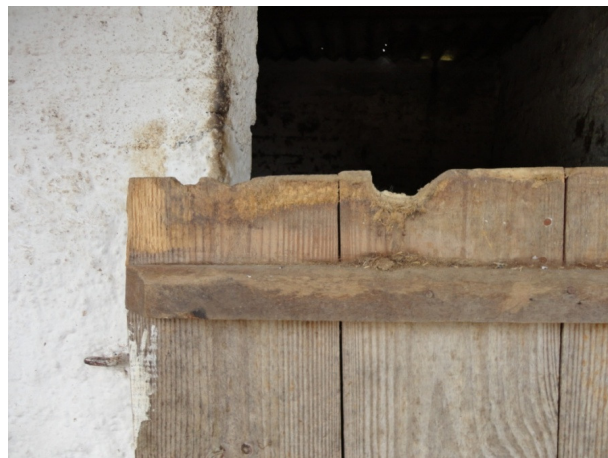
FIGURA 14- Porta danificada por animal com lignofagia.
