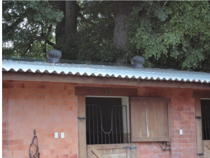
FIGURA 28- Estrebarias com exaustores.
