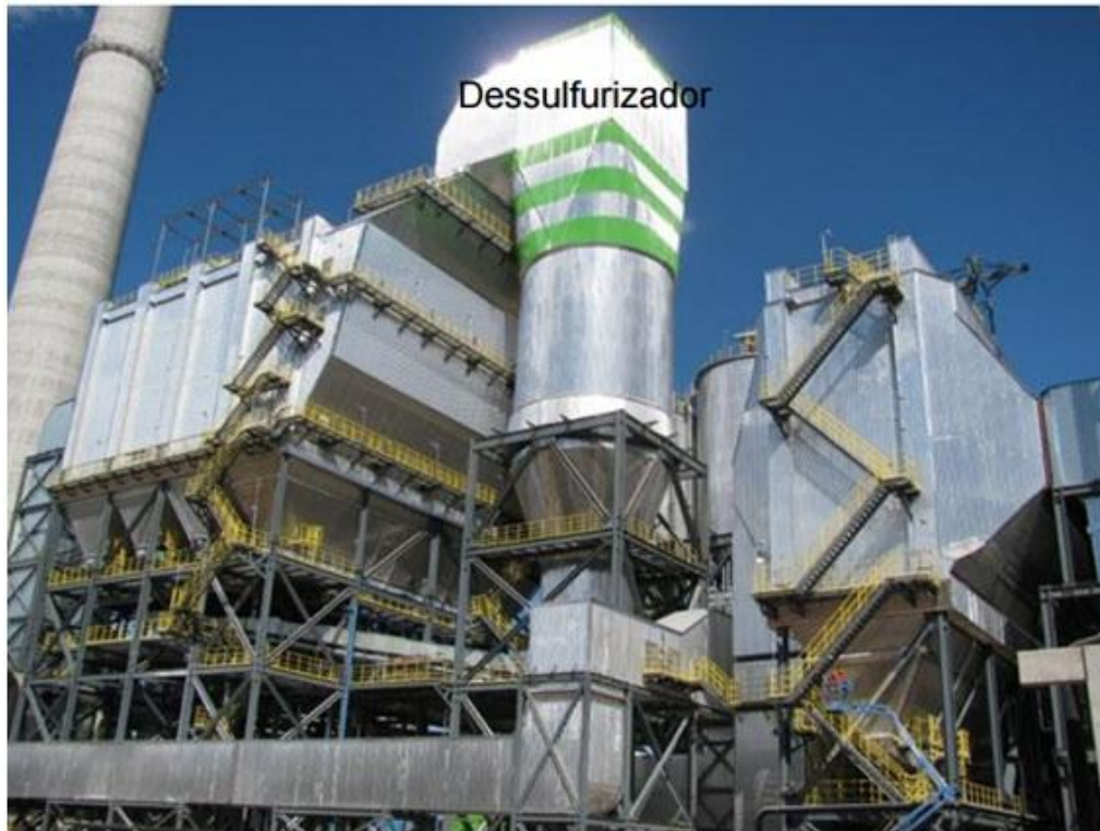
Figura 7 – Foto do dessulfurizador instalado na UPME.
