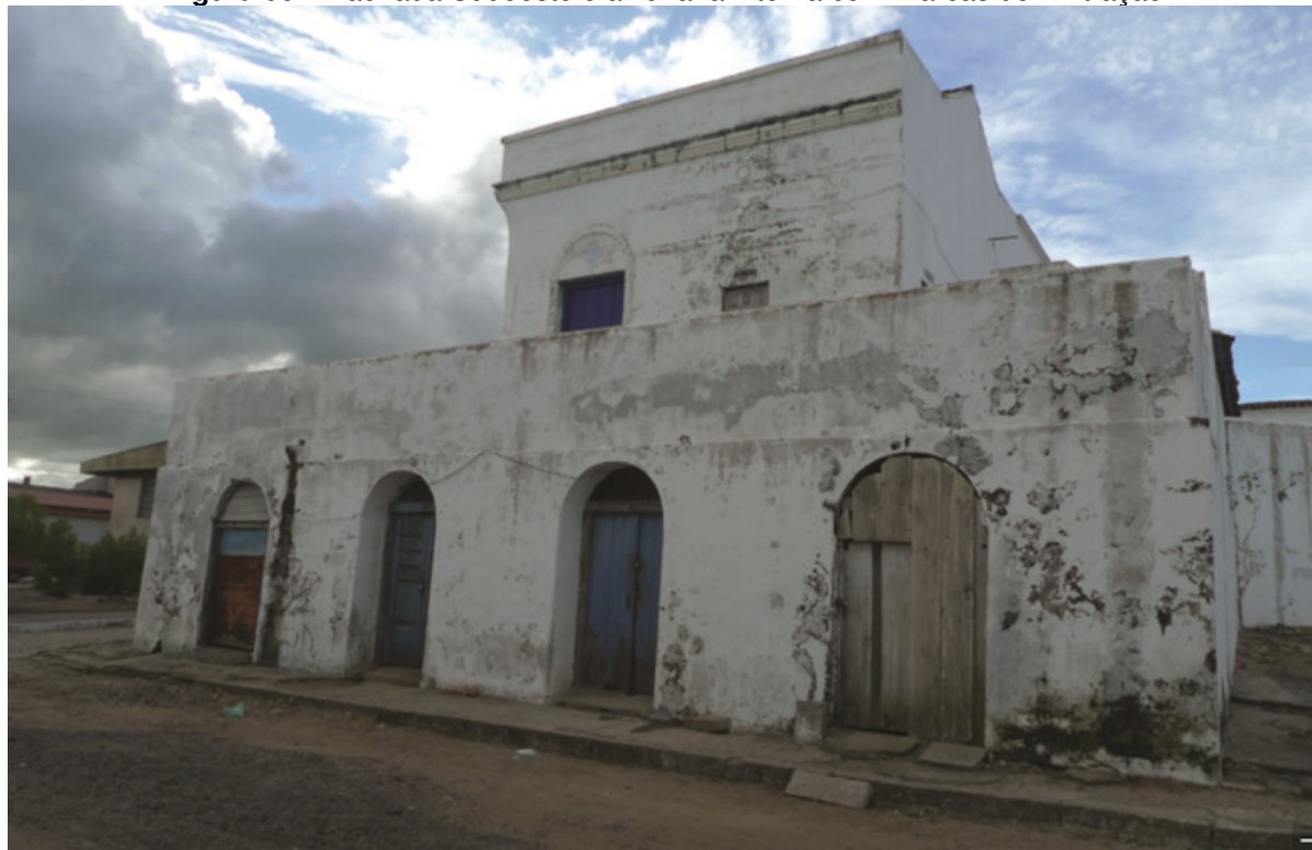
Figura 05 – Fachada Sudoeste e alvenaria interna com marcas de infiltração
