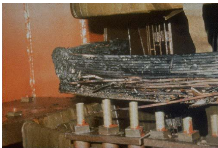
Figura 15 – Transformador com núcleo saturado.
