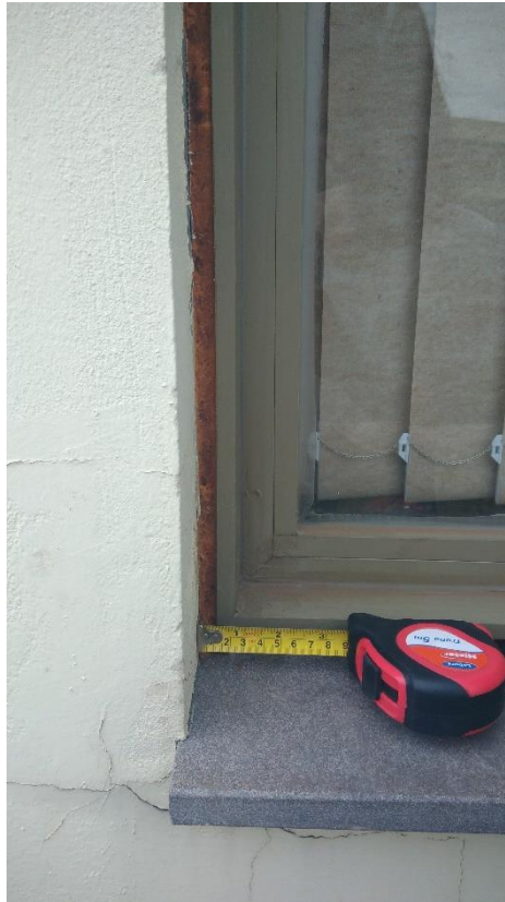
Figura 60- Erro de execução
