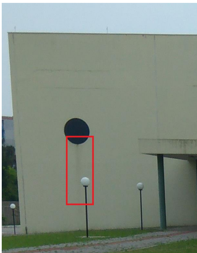
Figura 43-Manchamento da superfície esquadria fachada sul
