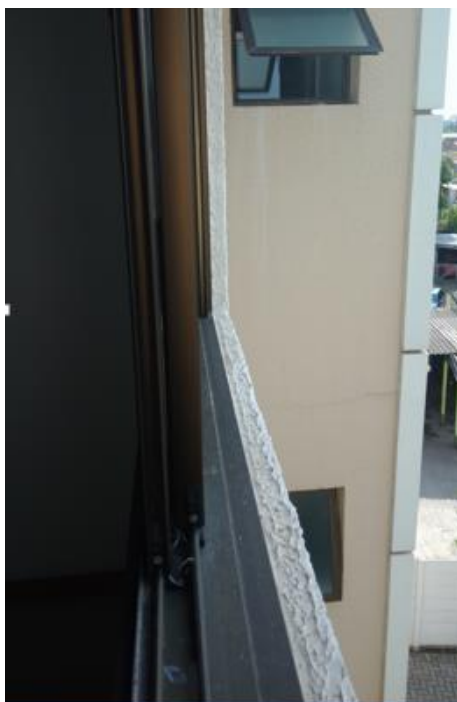
Figura 75- Ausência de peitoril janela 1EN
