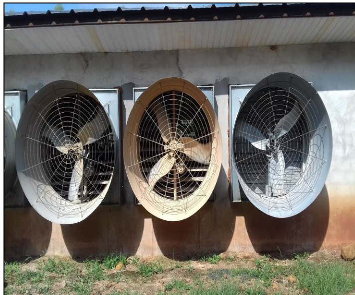
FIGURA 15 - Exaustores, vista externa. Fonte: Arquivo pessoal.
