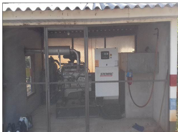
FIGURA 4 - Gerador de energia Fonte: Arquivo pessoal.
