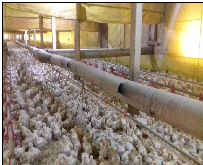
FIGURA 12 - Tubos distribuidores de ar quente. Fonte: Arquivo pessoal.
