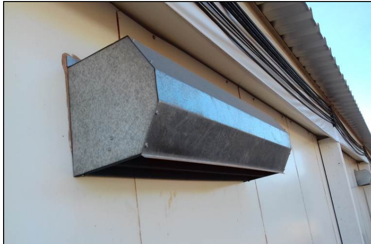
FIGURA 16 - Inlet , vista externa. Fonte: Arquivo pessoal.
