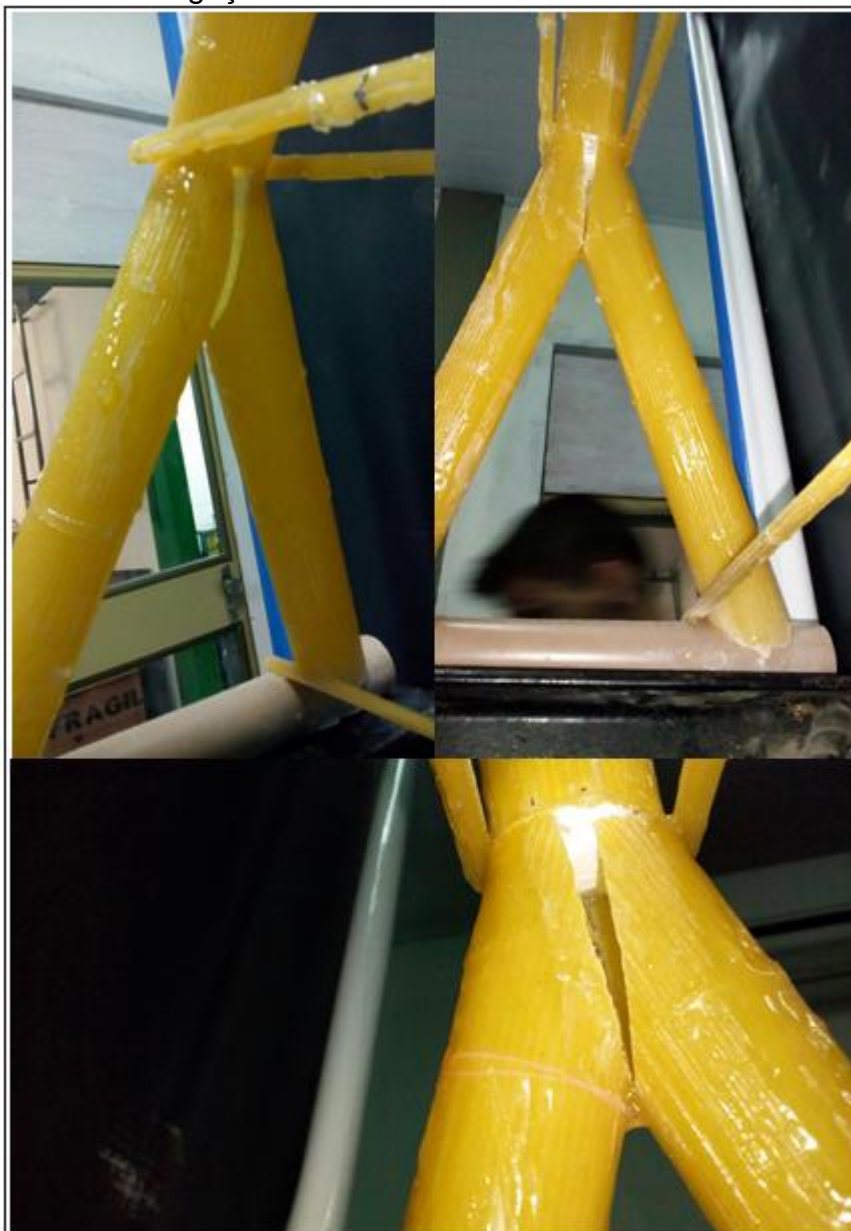
Figura 35 - Detalhe das ligações defeituosas
