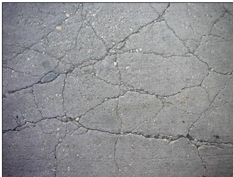
Figura 10 – Retração do concreto
