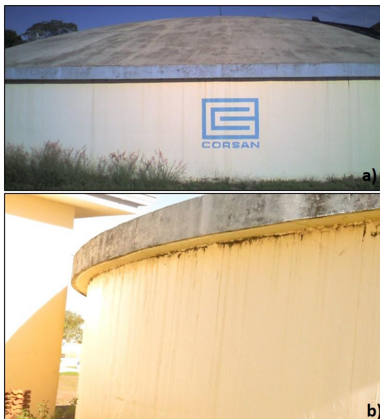
Figura 26 - Manifestações patológicas na face norte do reservatório R01
