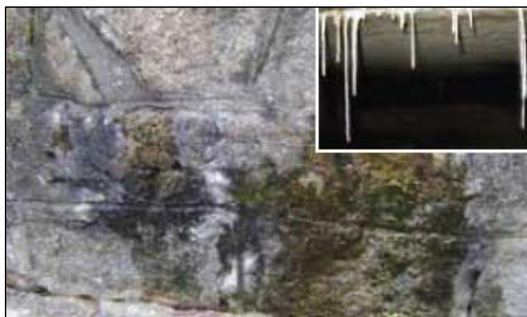
Figura 16 – Eflorescência no concreto
