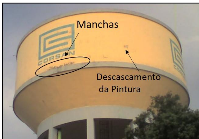
Figura 62 – Manifestações patológicas na face sudoeste do reservatório R05
