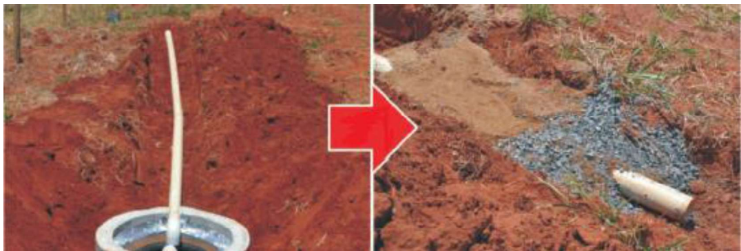
Figura 22 - Tubulação que infiltrará o líquido no solo
