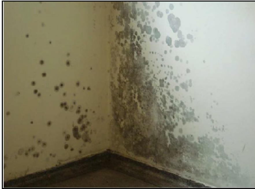
Figura 6 - Aspecto de mofo em paredes
