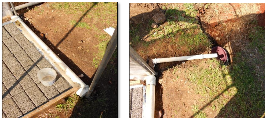
Figura 18 - Calha para a captação do escoamento
