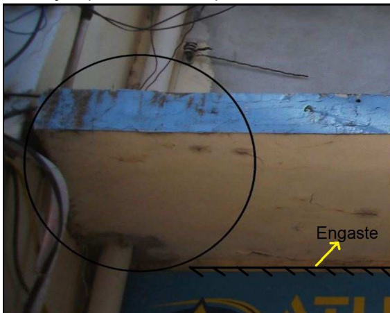
Figura 45 – Furo na laje para a passagem de tubulação pluvial, na marquise M3
