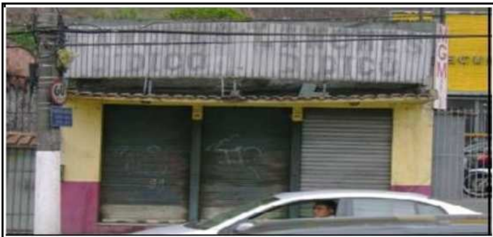
Figura 7 – Marquise deformada pela sobrecarga de painel publicitário.
