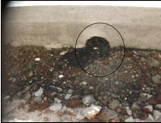
Figura 41 – Acúmulo de sujeira, junto ao coletor de água, na marquise M16
