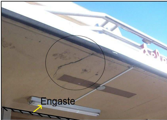
Figura 33 – Sobrecarga devido ao painel publicitário da loja, e aparecimento fissura perpendicular ao engaste, na marquise M23
