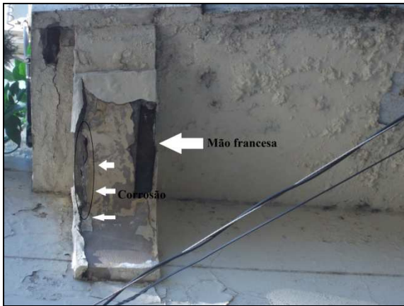
Figura 46 – Exposição da armadura e deslocamento do concreto na sacada acima da marquise M3
