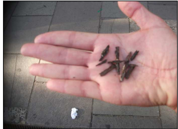
Figura 44 – Esfacelamento da armadura da marquise M3
