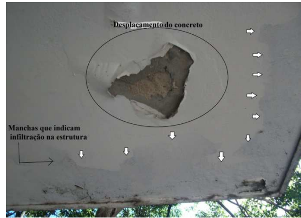
Figura 47 – Deslocamento do concreto, e manchas de umidade que indicam infiltração na laje da marquise M2
