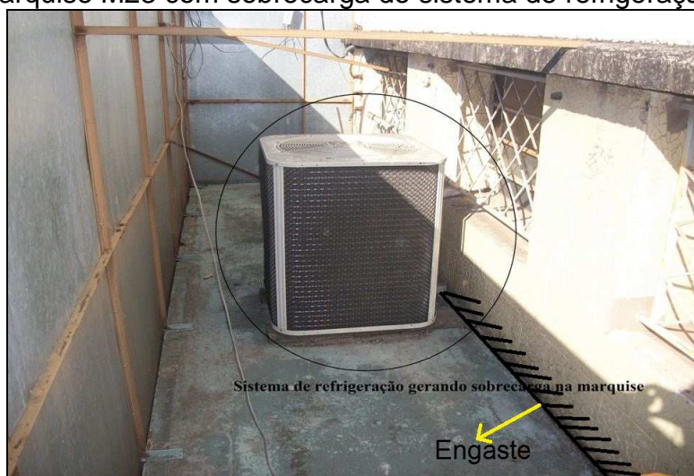
Figura 24 – Marquise M23 com sobrecarga do sistema de refrigeração
