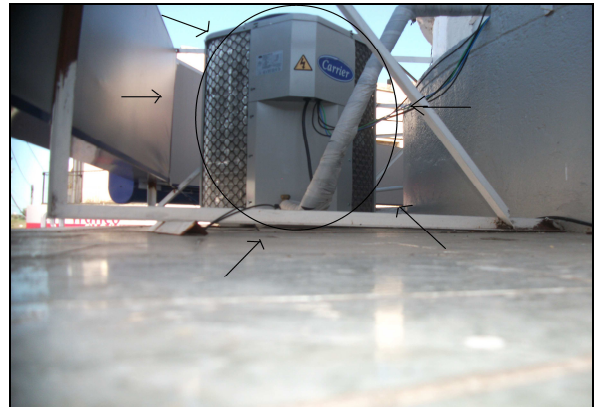
Figura 34 – Sobrecarga gerada por sistema de refrigeração na marquise M19, e perfuração no sistema de impermeabilização
