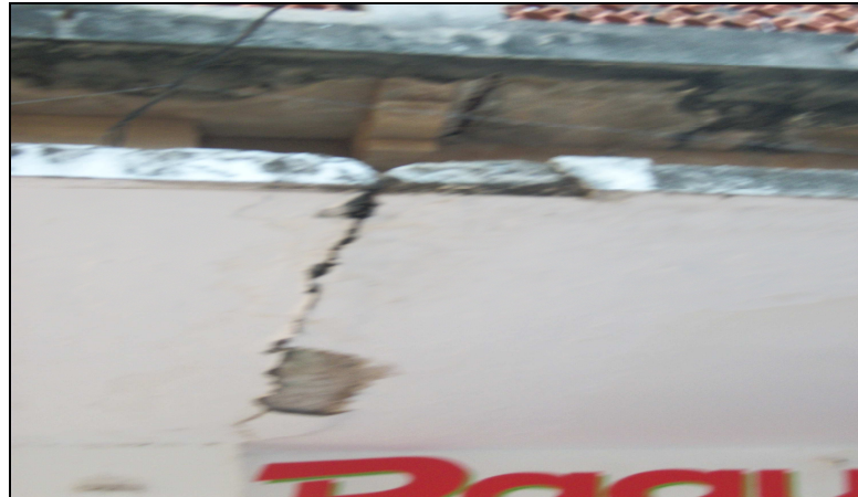
Figura 54 – Marquise M12 apresentando trincas transversais
