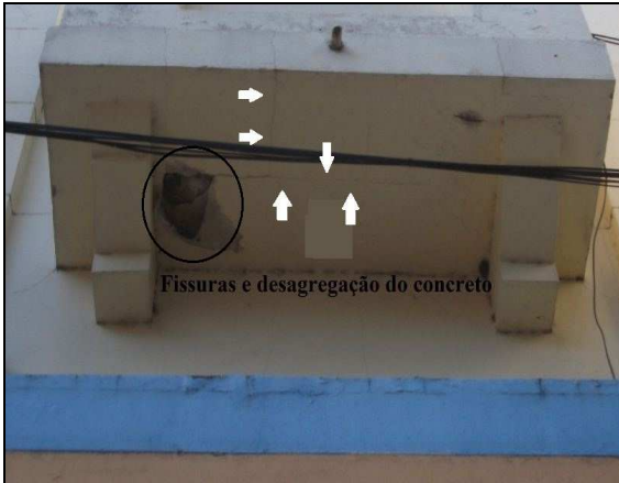
Figura 37 – Fissuras e deslocamento do concreto na sacada acima da marquise M3
