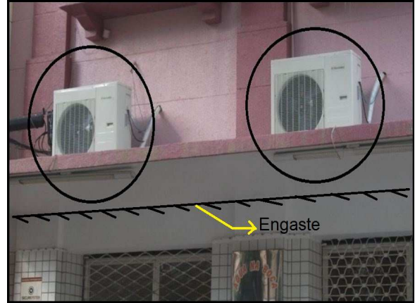
Figura 42 – Sobrecarga gerado pelo sistema de refrigeração, instalado na marquise M12
