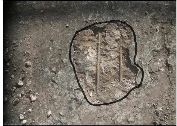
Figura 30 – Exposição e corrosão na armadura superior da marquise M17
