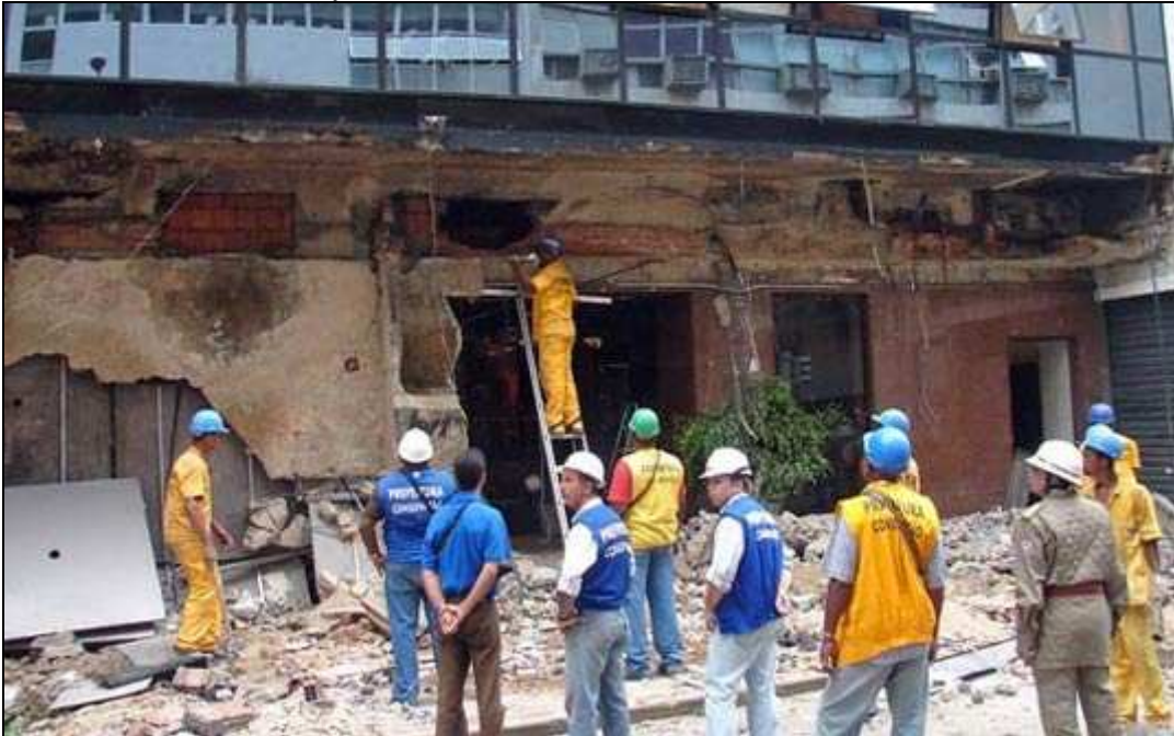
Figura 1 – Queda da marquise do Hotel Canadá
