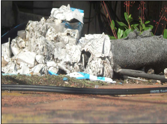
Figura 31 – Acúmulo de lixo na marquise M1, evidenciando a falta de cuidado com a estrutura
