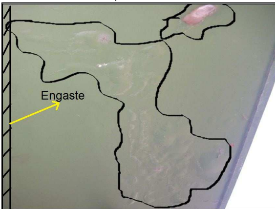
Figura 39 – Formação de bolhas e descascamento da pintura na sacada S5
