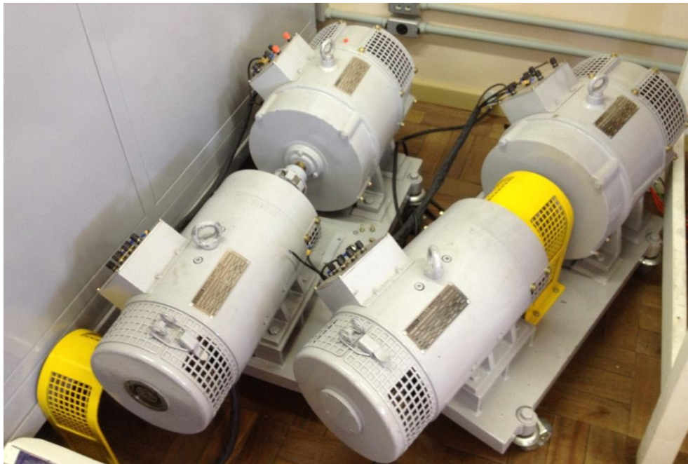
Figura 16 - Grupo gerador: Motor CC (Máquina primária) e alternador trifásico.
