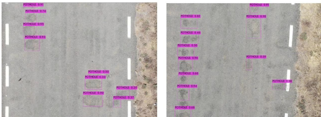
Figura 5 - Detecção automática de defeitos.
